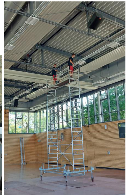
Umstellung Beleuchtung in der Bürohalle
